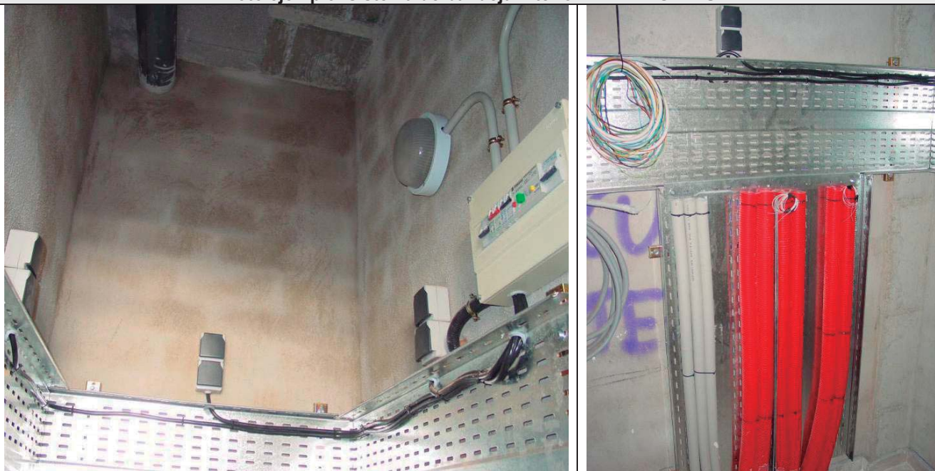
Foto ejemplo: sistema de bandeja interior RITU/ RITI / RITS para el tendido de los cables oportunos, disponiéndose en todo el perímetro interior a 300 mm del techo.
