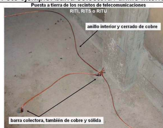
Foto ejemplo: barra colectora / anillo interior
