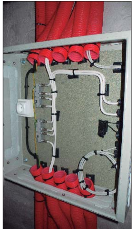
FOTO EXEMPLE DERIVADORS DE RTV-SAT UBICATS EN REG. SEC. DE PLANTA CONECTATS A T.T.
