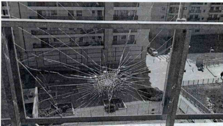
Vidres trencats a l'entorn de les escales mecàniques del carrer Vapor.
