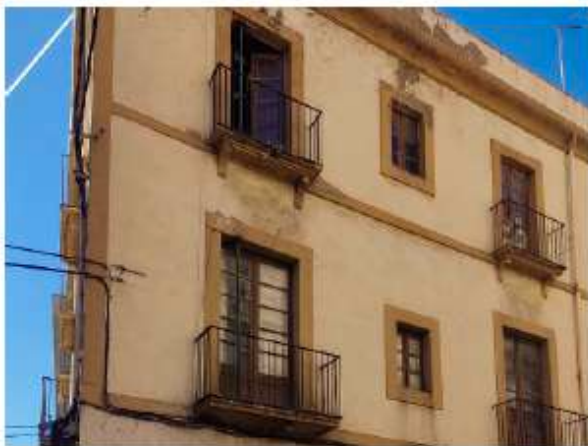
Figura 64. Edifici en mal estat del c/ Reial 8
