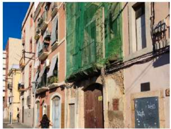
Figura 63. Edifici en mal estat del c/ del Mar 7
