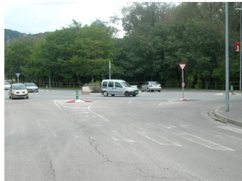
Senyalització horitzontal en estat deficient
