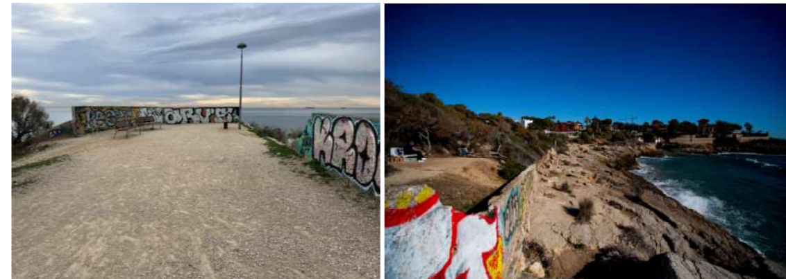
Fotos. Trams de murs de formigó que s'eliminaran per obsolets, insegurs, antiestètics i per separar la zona marítimo-terrestre de la part litoral. A les zones on hi hagi un risc de caiguda, s'hi ubicarà tanca de fusta de doble travessera horitzontal. Font: ©Eduardo Soler
