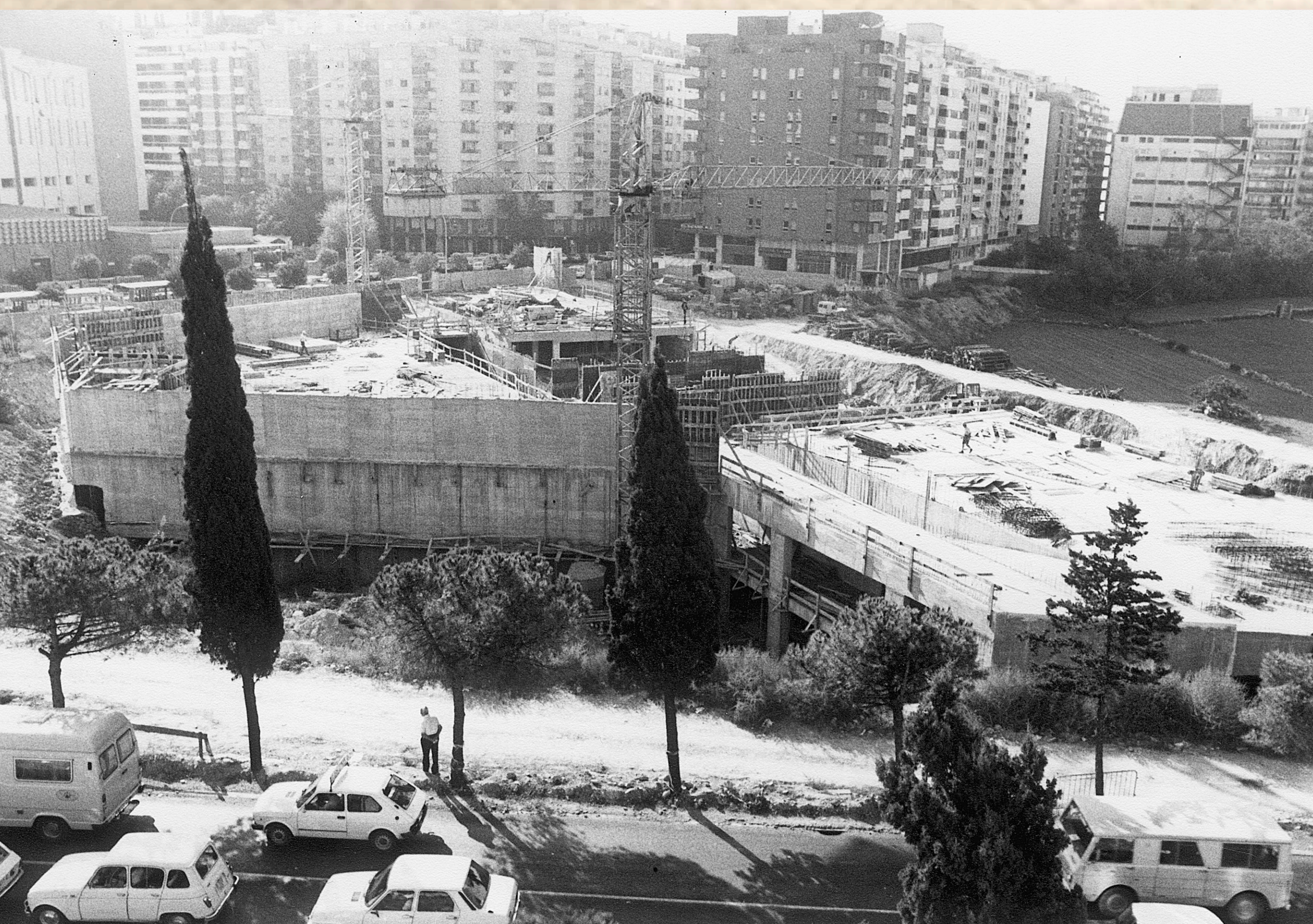
Obres de construcció de l'estació d'autobusos a la plaça Imperial Tàrraco, octubre de 1985. Foto Chinchilla, CIT / L'Arxiu
