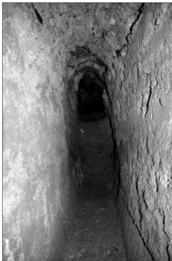
Fig. 50: Extrem meridional del segment recentment excavat de cuniculus. Volta amb encofrat perdut realitzada en opus caementicium. Foto: J. M. Macias.
