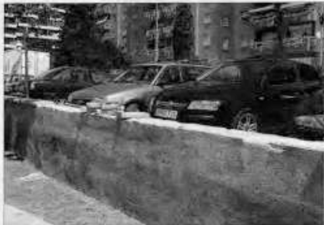
En la plaza Cuba, en Sant Pere i Sant Pau, el muro de contención se encuentra en mal estado. FOTO: DT
